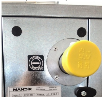
Označení vstupu do výměníku.
