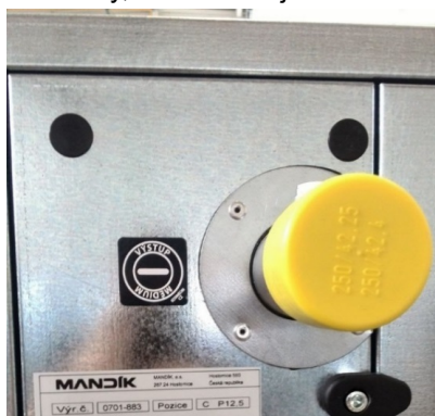
Označení vstupu do výměníku.
