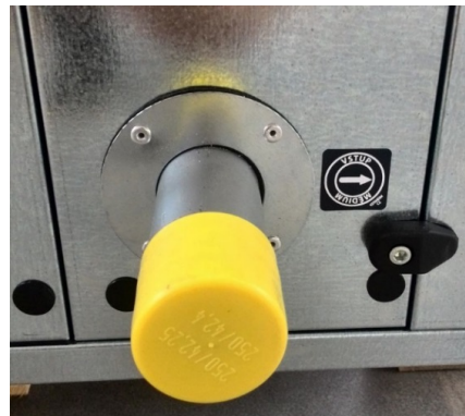
Označení výstupu do výměníku
